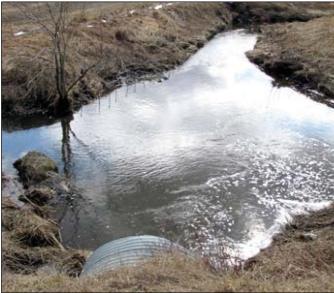
Photo 8 : Élargissement du lit d'un cours d'eau en aval d'un ponceau Source : Mikael Guillou, MAPAQ
