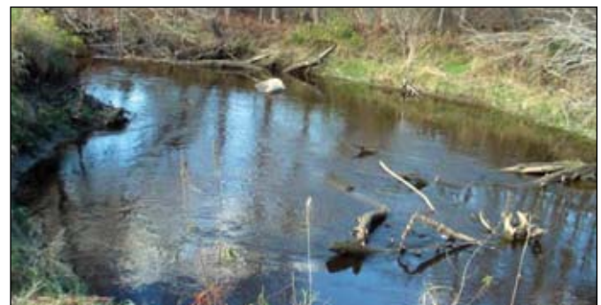
Photo 10 : Érosion de la rive suite à un encombrement du lit du cours d'eau Source : Victor Savoie, MAPAQ
